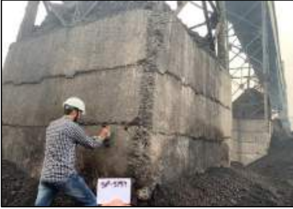
कोल हैंडलिंग प्लांट में कन्वेयर बेल्ट के आरसीसी पेडस्टल पर फेरो स्कैनिंग टेस्ट
